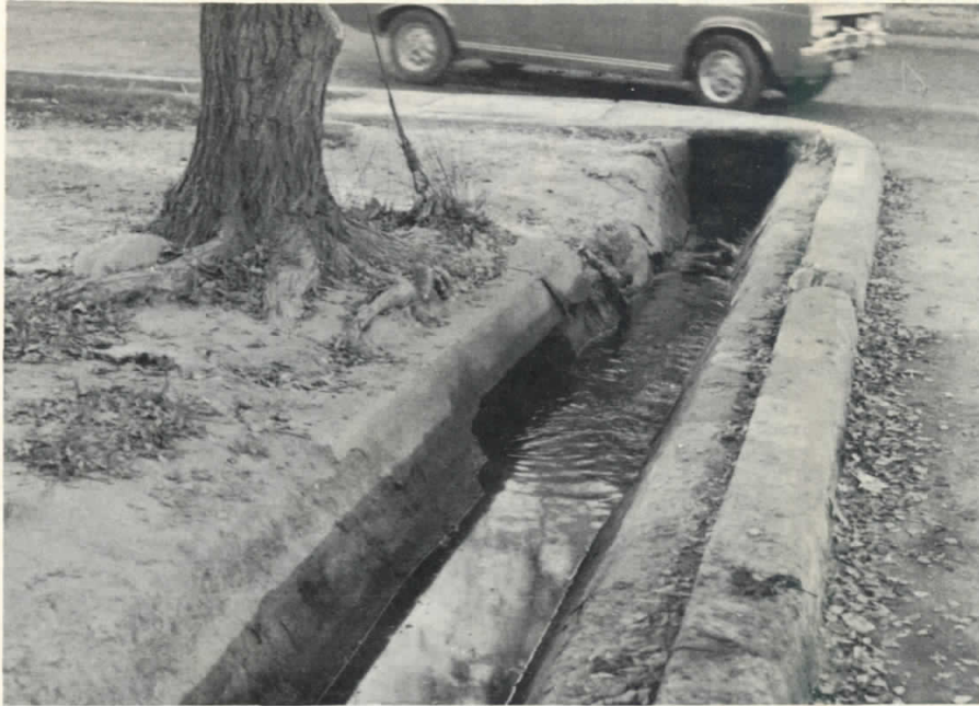
Fot. 8 — Acequia de la esquina de Perú y Coronel Plaza, con la boca de salida de un canal de desagüe residual.
